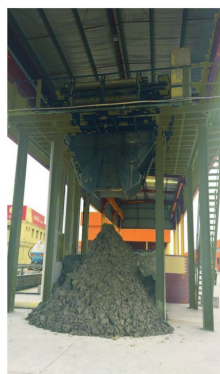
石材废水处理
