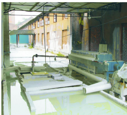
石材废水处理
