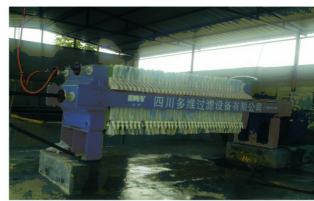
油田采气废水处理
